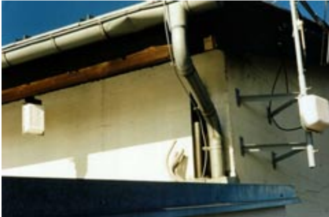
Im geschützten Gehäuse Empfangs- (links) und Sende- (rechts) Antennen Richtung IMST und ZUGSPITZE
