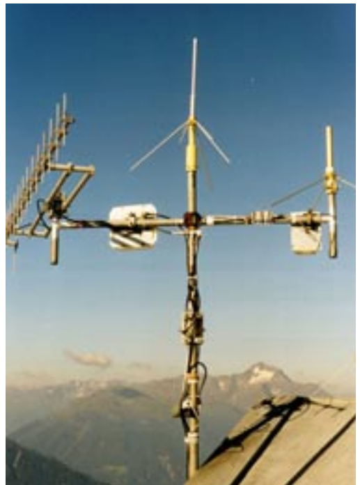
Im geschützten Gehäuse Sende- und Empfangs-Antennen Richtung Landeck, in der Mitte, SPC-Konverter, rechts 2 m RX-Antennen
