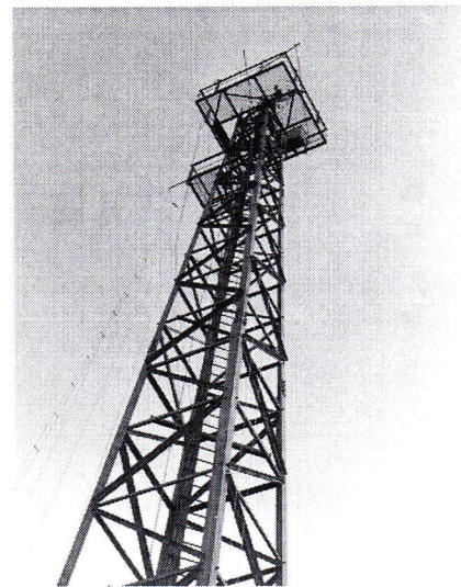
Gittermast mit montierten Antennen
