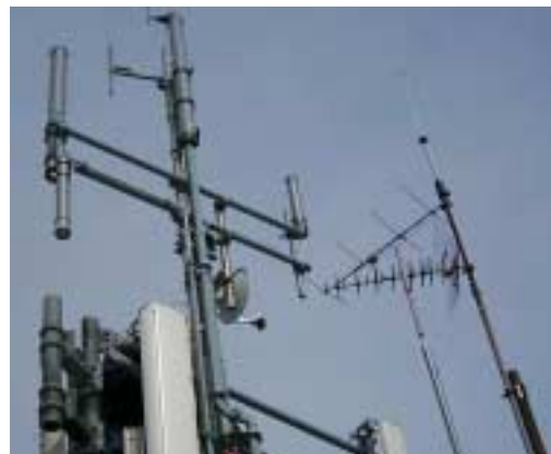
Antennenanlage: 5712(TX) Mitte oben, 2343 (RX) links oben, 10180(TX) links unten, 10400(RX) rechts oben, die sep. 2 m Empfangsantenne links neben der Rundfunkantenne.
