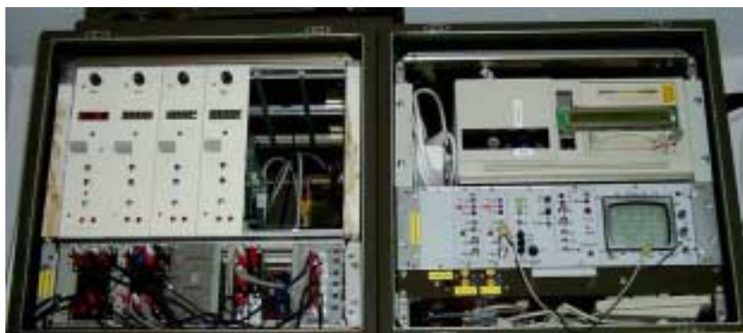
Station: RX Einschub links oben, Audio/Video MATRIX links unten, PC 386 rechts oben, Sendereinschub mit 2m RX und Videomonitor r. unten.
