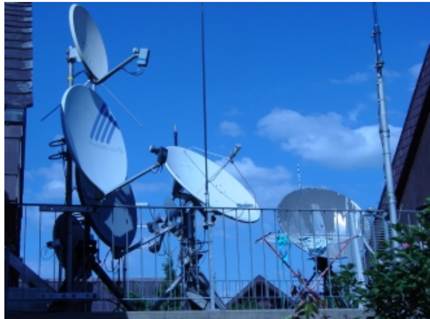
Antennenterrasse am Wohnort von HB9TJ in Belp. Ganz unten rechts: Gitter- Parabol (Poulet-Rost) ehemalige EMI-Link (4,5 GHz) im Einsatz als 1,6 GHz Meteosat-Empfänger.
