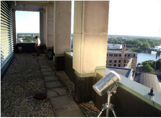
1270-MHz-Empfangsdose für ein Kamerasignal von einem anderen Hochhaus rechts
