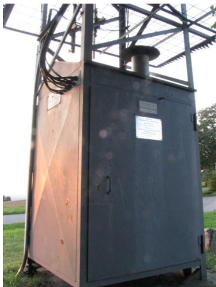
Das kleine Betriebsgebäude beinhaltet Betriebsfunk, Kachelmann-Meteo und DB0RV
