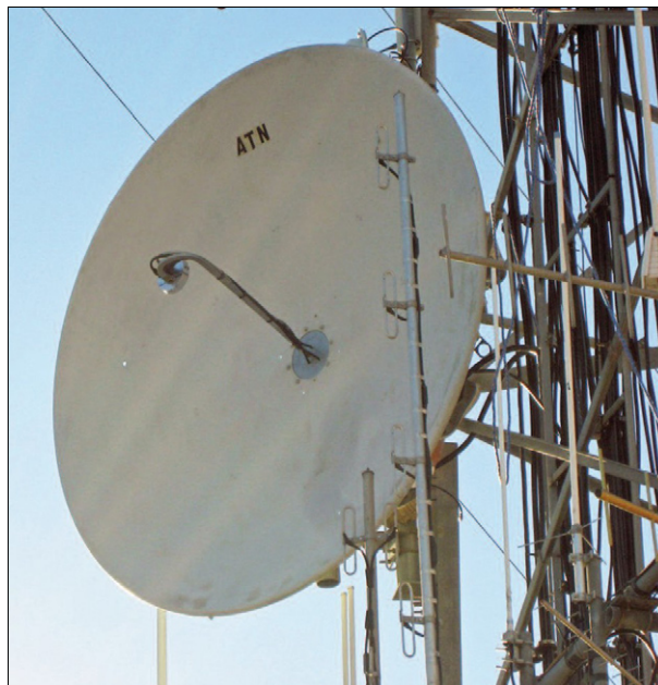
Der neue Strahler ist am Parabolspiegel montiert.
