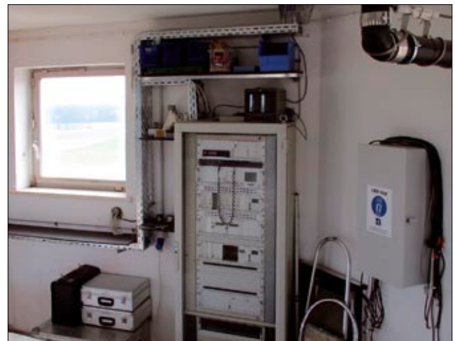
Neues DBØQI-Gestell im Wasserturm in Vierkirchen.
