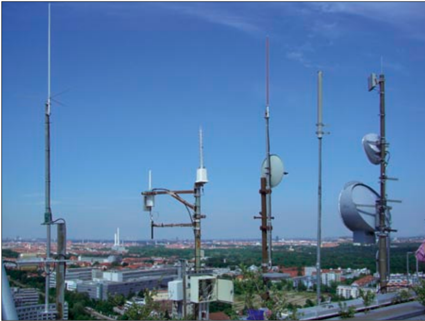
Die Antennenanlage von DBØQI auf dem Hochhaus in München-Sendling.
