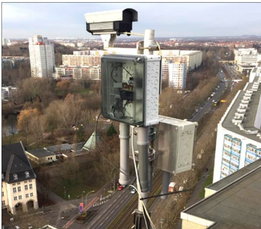
In dem Profgehäuse (unten) ist ein 24-GHz-ATV-Sender mit Sektorantenne, den Thomas, DC7YS, zu Testzwecken ferngesteuert einschalten kann.
