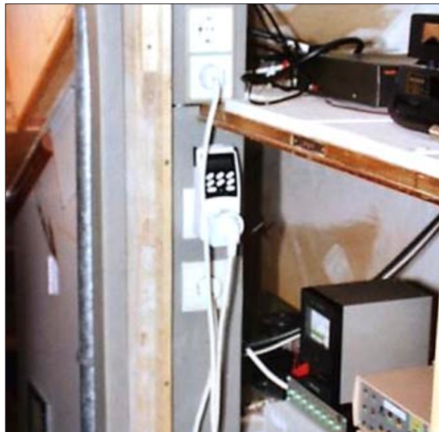
Das DBØKN-Shack unterm Dach
