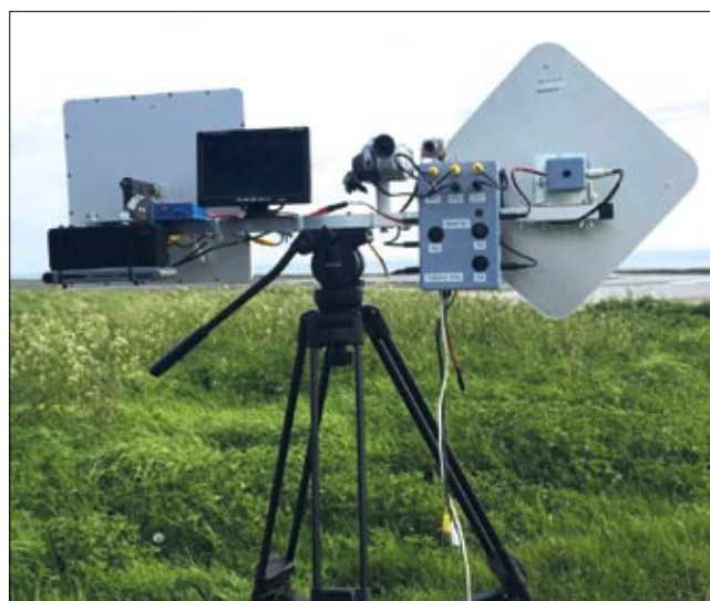
Auf Stativ montiert: Handelsübliche 5-GHz-Panelantennen
