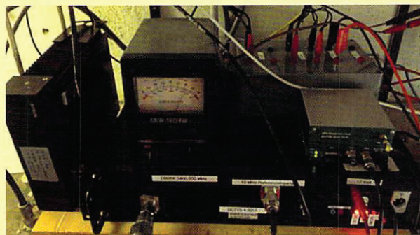
Bild 3: 9 cm Bake und Steuerung
